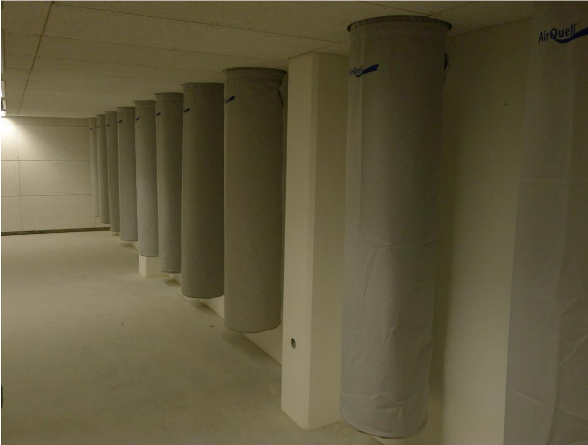
Quellluft-Auslässe im Bereich der scharfen Waffen (hier: 100mtr/50mtr) Foto: Lange
